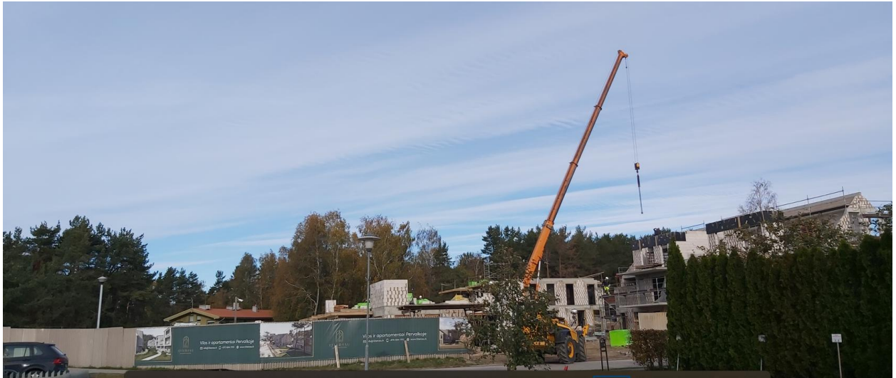
1.1 pav. Sklype, adresu Pervalkos g. 12 vykdomi pastatų rekonstravimo darbai, kurie stebimi nuo Pervalkos molo (stebėjimo taškas Nr. 15)
