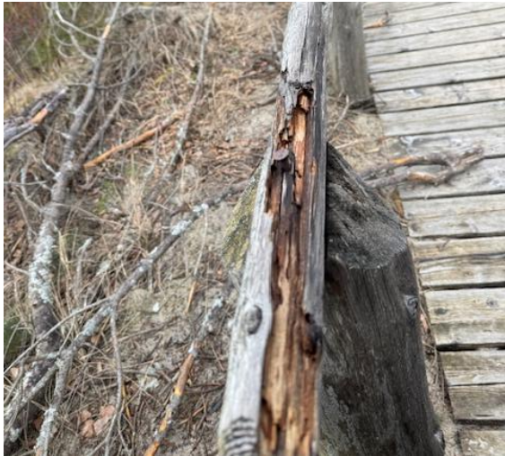
7.16 pav. Sulūžę turėklai.
