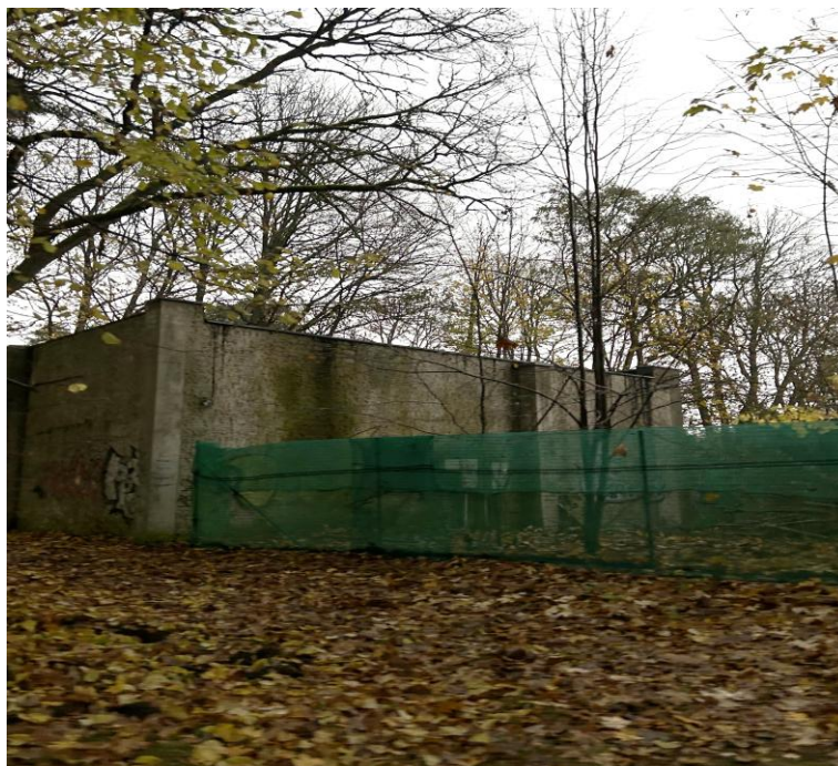
5.15 pav. Elektros transformatorinė Vilų g. 12T.
